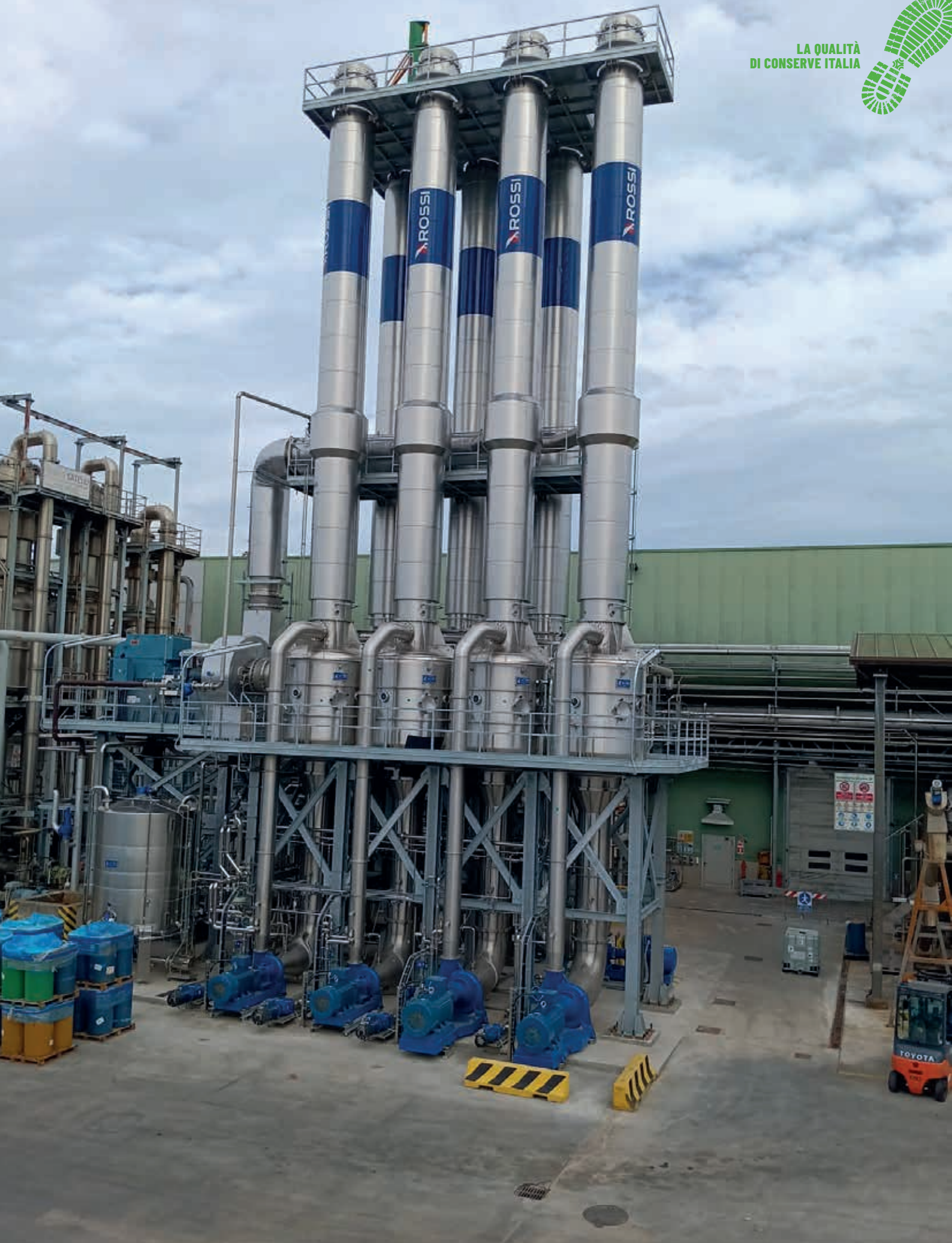
Nuovo concentratore pomodoro a ricompressione meccanica, stabilimento di Codigoro (FE)
