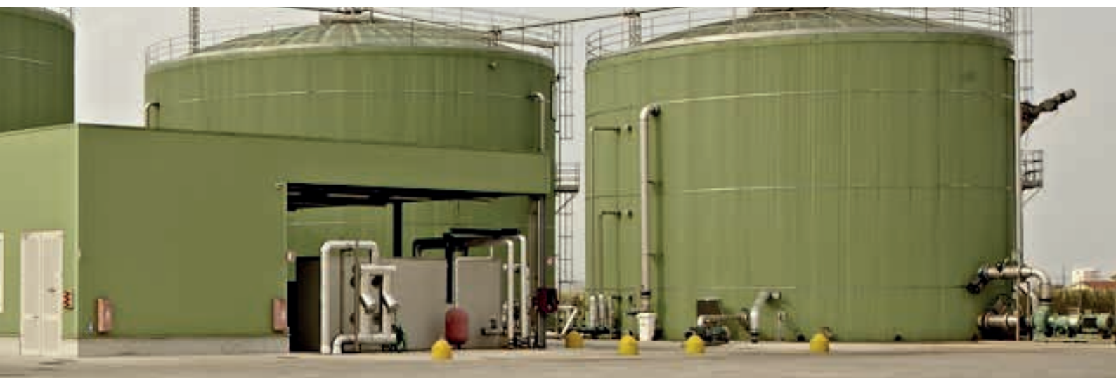
Impianto per la produzione di biogas, stabilimento di Codigoro (FE)
