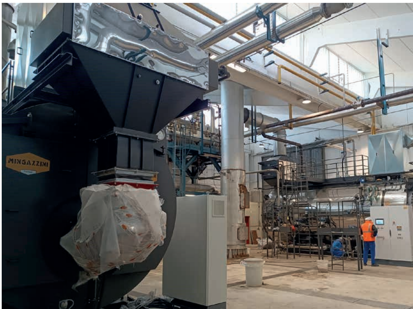
Nuove caldaie centrale termica di Barbiano (RA)
